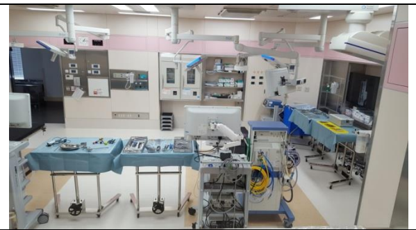
Training-Operation-Room mit höchsten Standards
