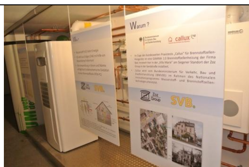
Brennstoffzelle Villa ZCS, Denkmal I
