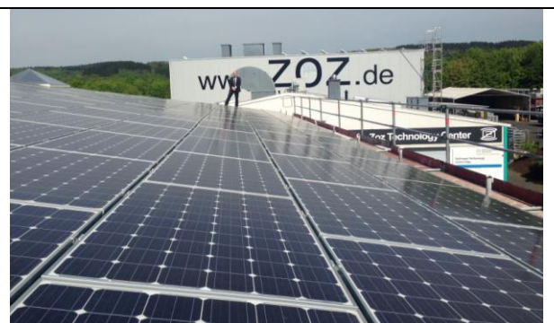
Teilfläche der PV-Anlage am ZTC, ca. 0,2 MW Spitzenleistung
